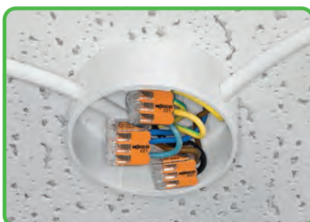
Rozvody pro světlo ve stropě
